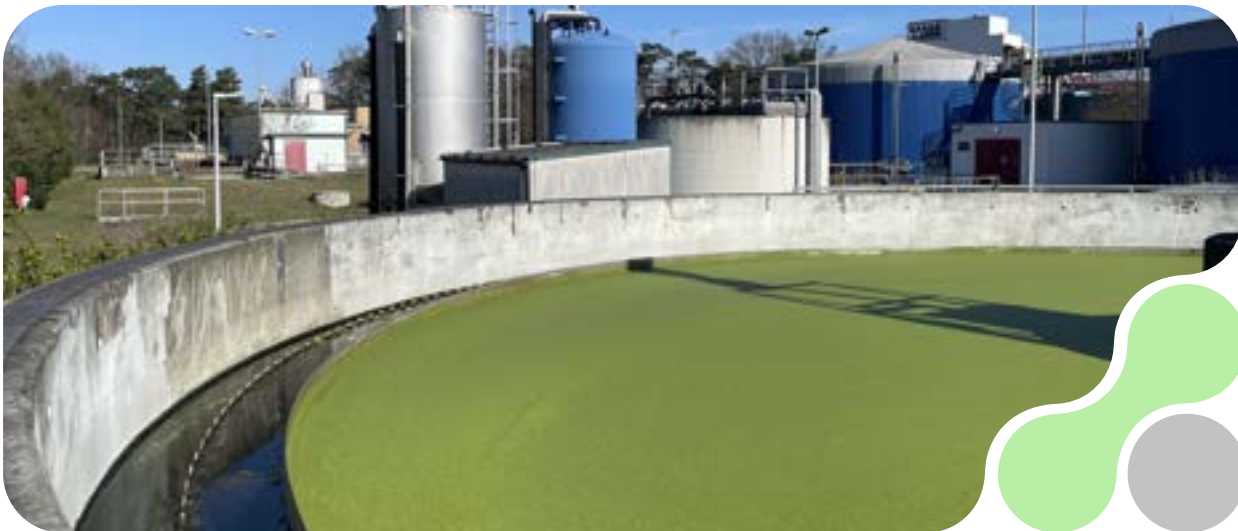
Simtra's Wasseraufbereitungsanlage vor Ort in Halle.
